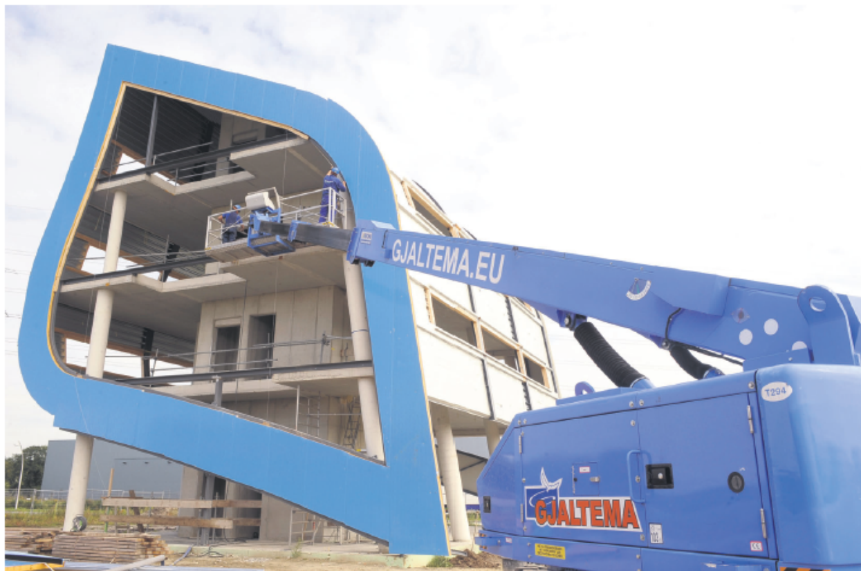
Het opdrachtgevende ingenieursbureau Sparkling Projects gaat zelf een deel van het gebouw betrekken. Foto: Dijkstra/Peter Brom
